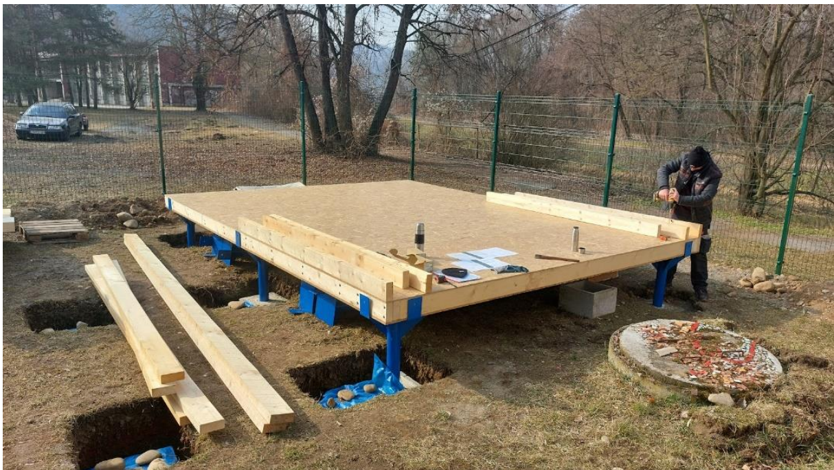
Obrázok 12. Kotvenie základových prahov do základovej dosky z rebrových panelov. (foto: P. Štompf).
